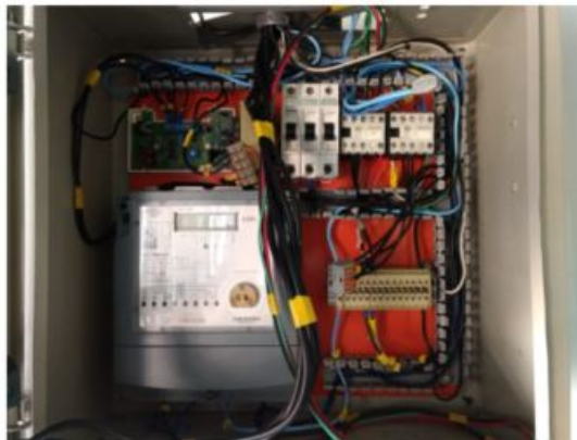
Figura 2.4 – Interior do quadro de acionamento.
