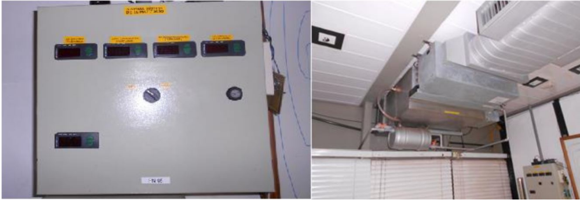
Figura 2.3 – Ar condicionado da sala de reunião (painel de controle, unidade evaporativa).
