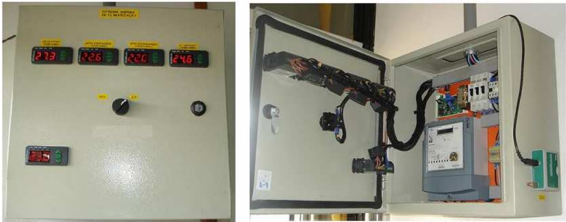
Figura 4.10 – Vista externa e interna do painel elétrico de controle
