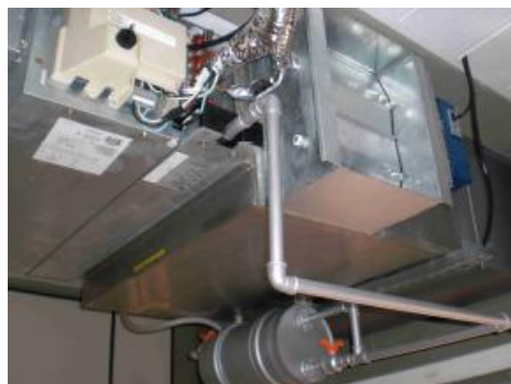
Figura 3.2 – Split dutável, damper e sistema evaporativo.
