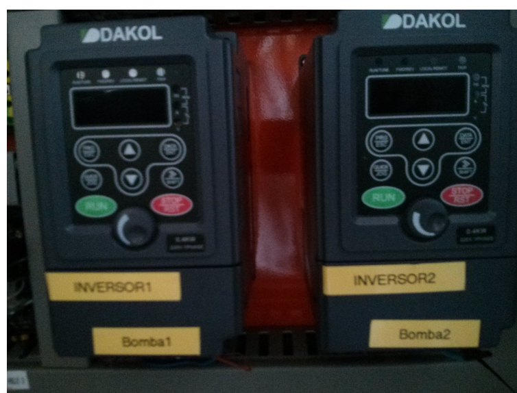
Figura 8 – Inversores de Frequência
