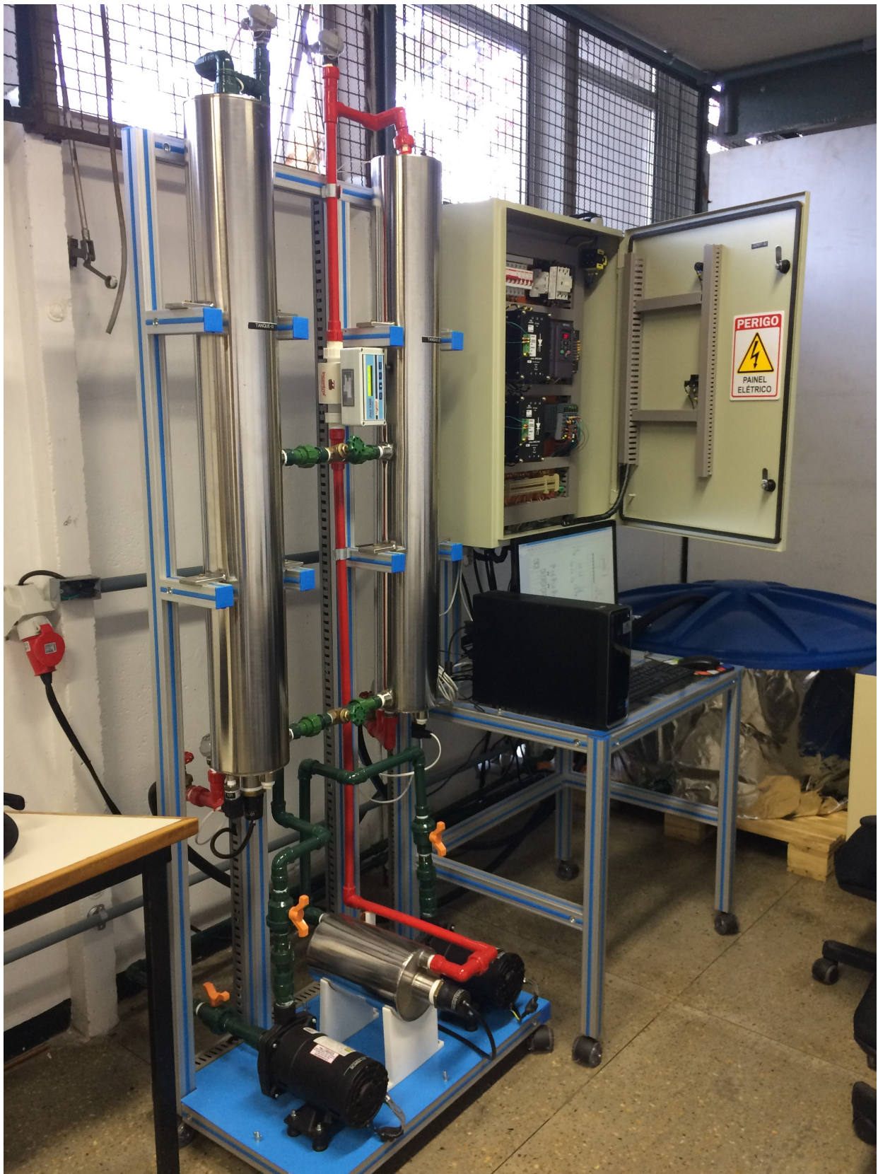
Figura 2.1: Instalação física da planta piloto
